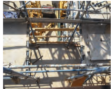
Fehlende Bodenbeläge am Gerüst
