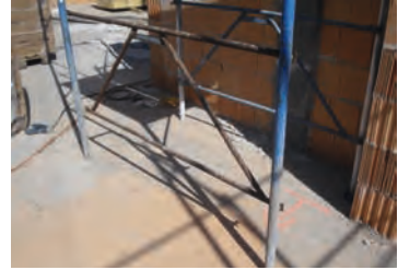
Fehlende Gerüstfüße und Lastverteilungsbretter am Gerüst
