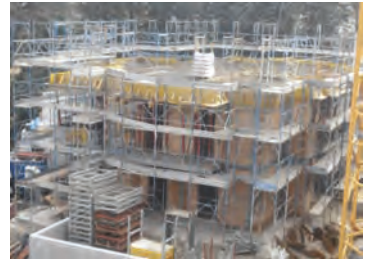
Ordnungsgemäß errichtetes Fassadengerüst als Absturzsicherung
